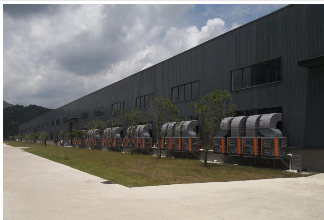
车间换气通风装置及绿化
