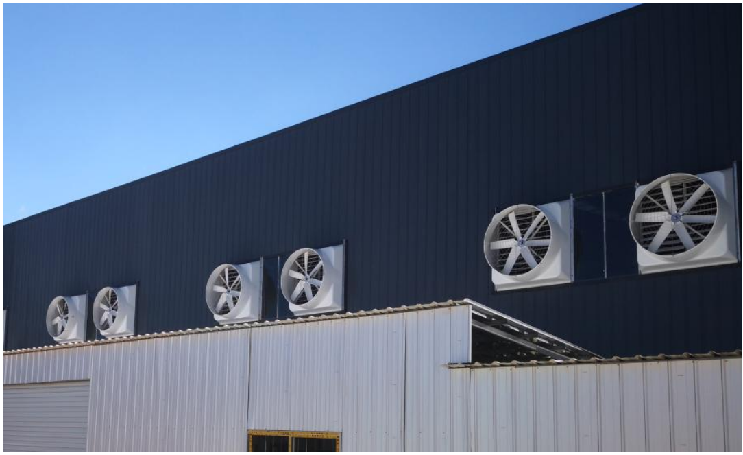
车间通风装置
