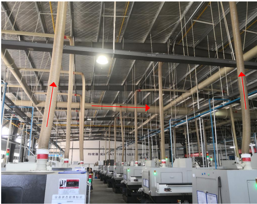
切削液挥发废气收集管道
